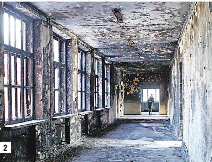
Вчера 11:25 Представитель компании-инвестора Елена Шенкарева приехала осмотреть здание бывшей школы на улице Ухтомской (1) Вчера 11:37 Четвертый этаж здания серьезно обгорел. Его, как и все строение, придется капитально ремонтировать инвестору (2)
