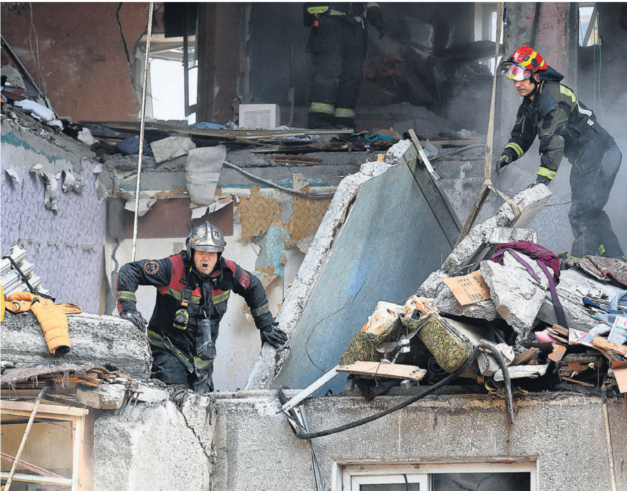
Обрушения в жилом доме после взрыва газа продолжались даже во время спасательных работ ФОТО ЕВГЕНИЯ РАЗУМНОГО
