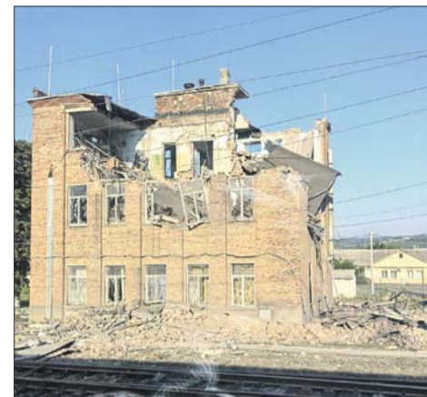
В здании железнодорожного вокзала загорелась кровля.
